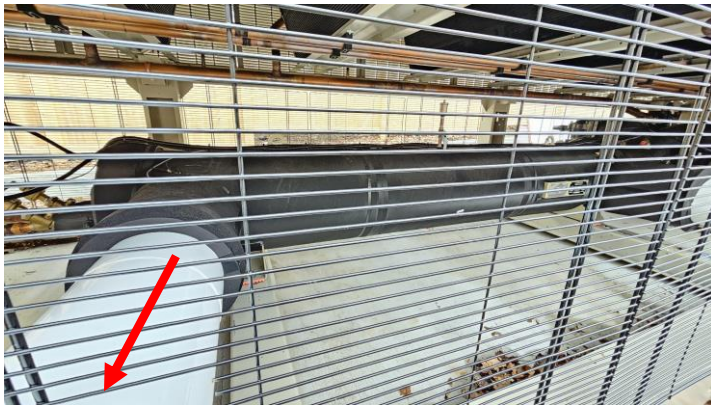
Lowell ES Chiller (Discharge / Outlet)
